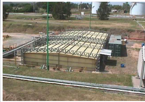
Piletas separadoras API
